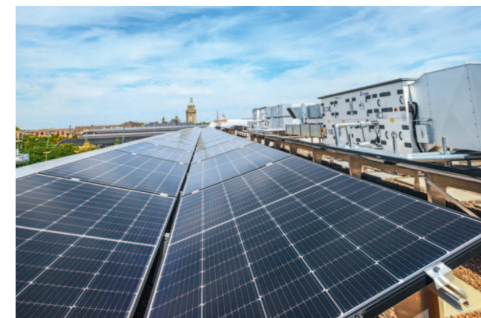
Photovoltaik auf dem Dach komplettiert das klimafreundliche Profil
