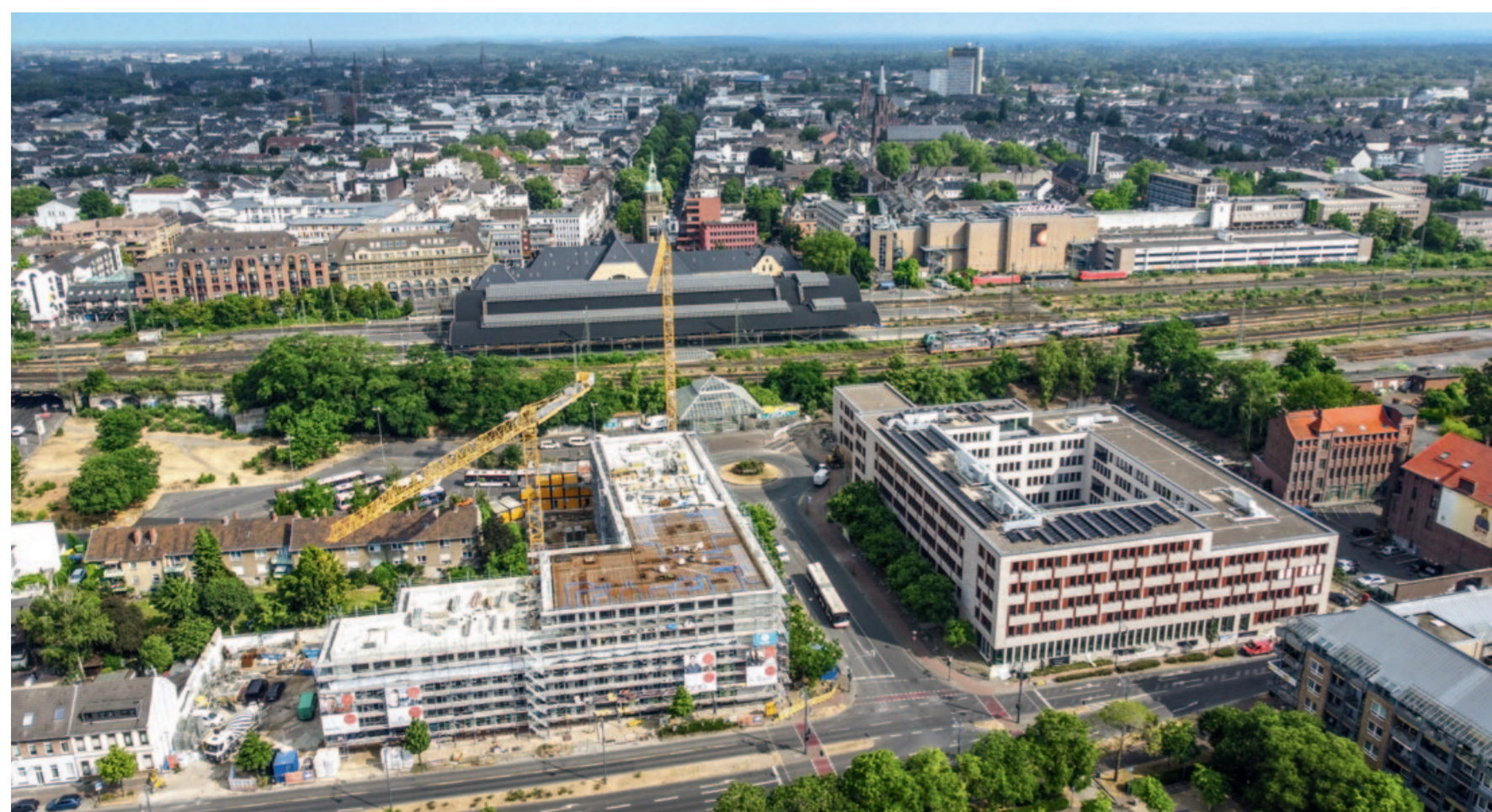
Hier entsteht ein städtebauliches Aushängeschild für Krefeld: Wo bis vor Kurzem eine Brache war, bilden BOB und OPUS – beides Projekte von Dreßler Bau – künftig ein repräsentatives Entree zum Bahnhof
